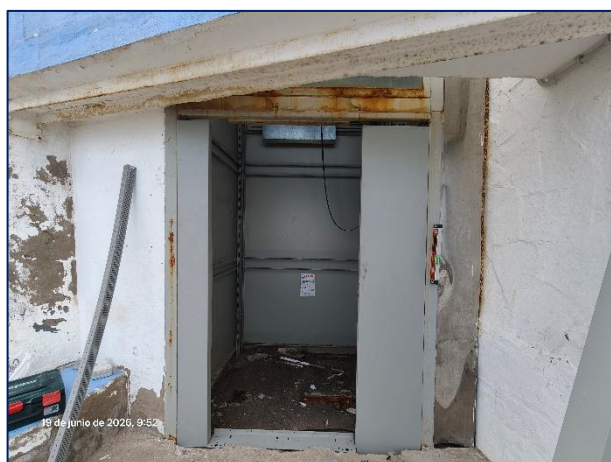
Ascensor exclusivo para PMR (en reformas).
